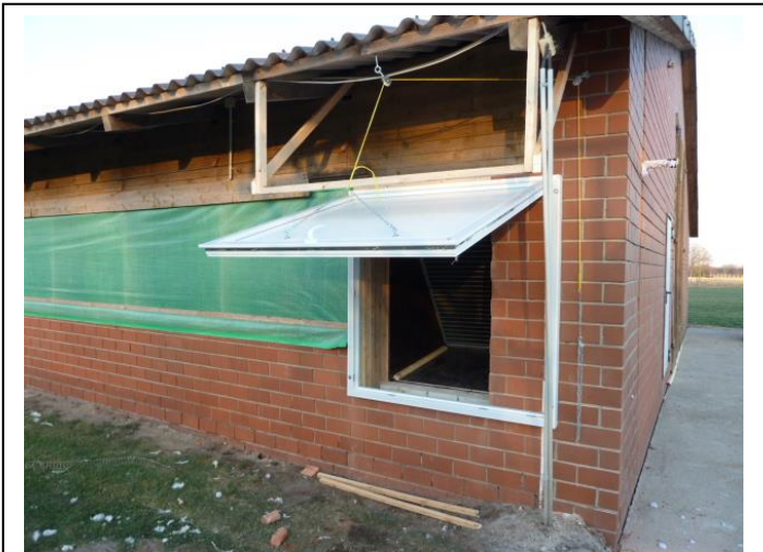
Abbildung 14: Westwand des Putenstalls umgebaut mit Einlass für Luft in den Wärmetauscher, Foto: Borderstep
