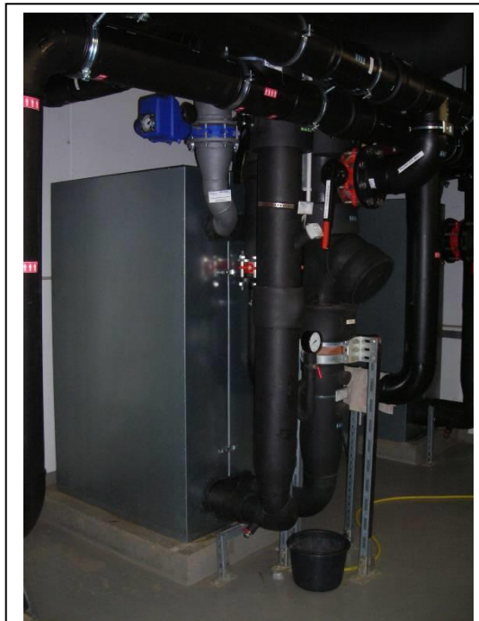
Abbildung 11: Plattenwärmetauscher, Foto: Borderstep
