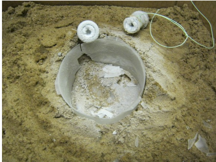
Abb. 1: „Gesprengtes“ Stahlrohr mit Eiskern
