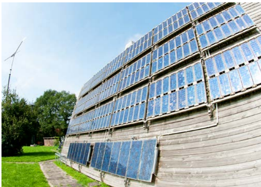
„Linien der Forschungen zu erneuerbaren Energien“: Die Pläne zum energieautarken Energielabor – hier dessen Photovoltaikanlagen – entstanden in den 70er Jahren.
