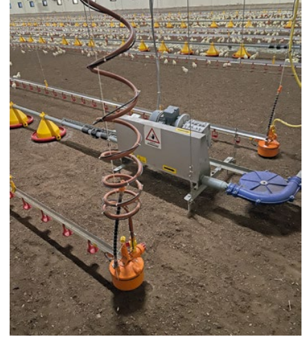
An dieser Einrichtung lässt sich der Wasserdruck in den Tränkelinien einstellen. Auch das trägt zu weniger Einstreufeuchte und geringerem Wasserverbrauch bei.
